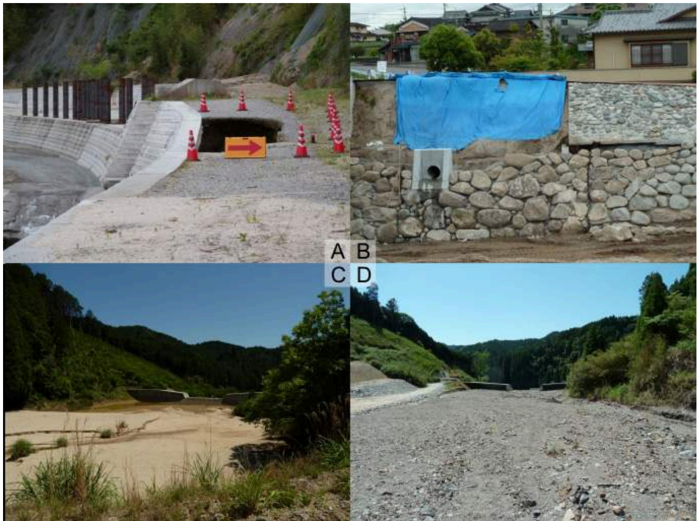
Fig. 7 – Dégâts sur les structures de protection nouvellement construites.
